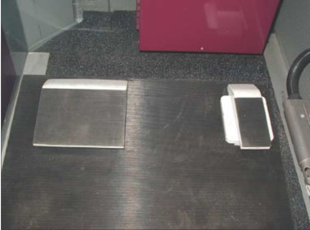
Slika 1: Nožni prekidači ugrađeni u vozačku kabinu lokomotive
