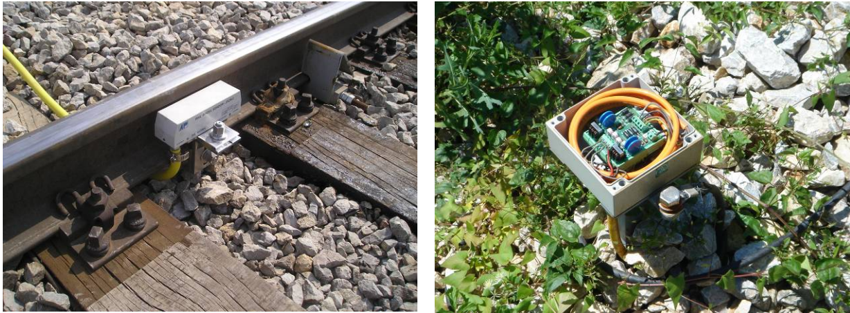
Slika 2: Senzor željezničkog kotača ZK24-2 montiran pomoću nosača na tračnicu i modul zaštite od grmljavine ZGK u prespojnoj kutiji uz kolosijek
